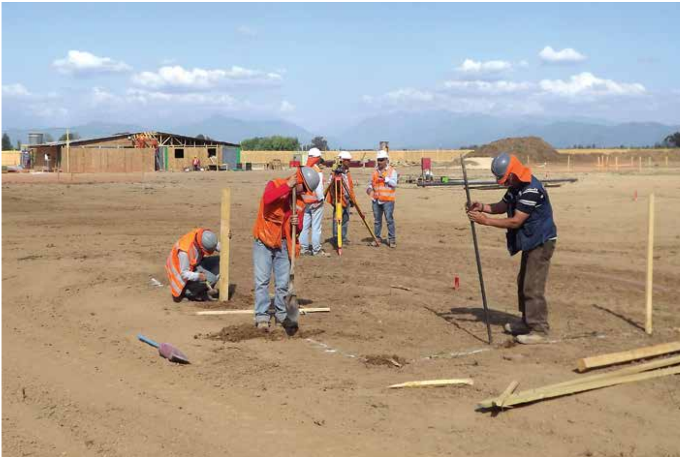
Las faenas para cimentar los edificios del Campus Linares en una superficie de 6 mil 387 metros cuadrados al oriente de la comuna, son ejecutadas por la Empresa Cuevas y Purcell por mandato de la Dirección de Arquitectura de la Seremi de Obras Públicas. Los trabajos iniciales consisten en el movimiento de tierras para nivelar el terreno y el cierre perimetral del lugar, para dar paso al levantamiento de edificios.
